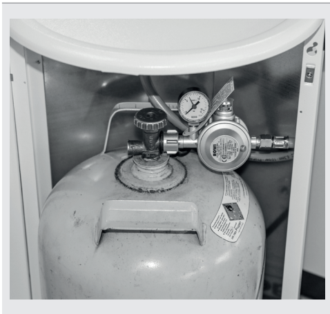
Abb.3: Installation der Gasflasche
